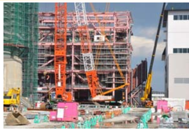
廃熱回収ボイラ
