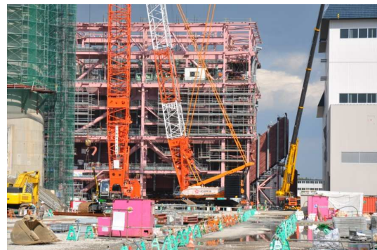
廃熱回収ボイラ
